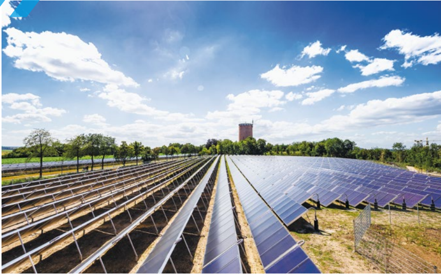
1.088 Kollektoren sammeln Sonnenenergie
