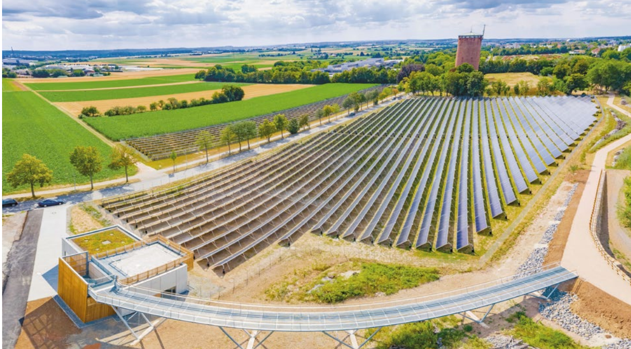
Das Solarfeld mit Schaltzentrale und Sonnenpfad
